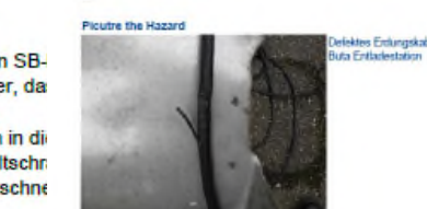
Defektes Erdungskabel in der Buta Entlastestation
